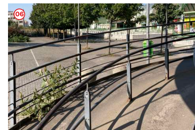
Nevyhovující spirálová rampa
