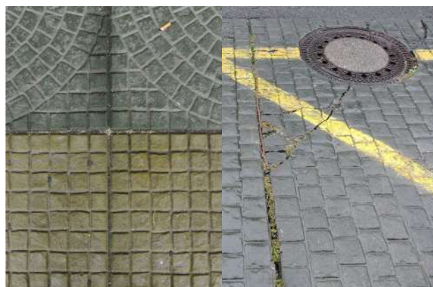
Degradované povrchy zpevněných ploch
