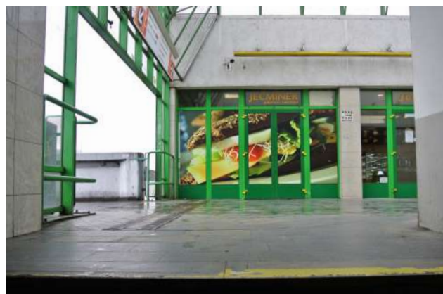
Nedostatečné stavební oddělení interiéru a exteriéru
