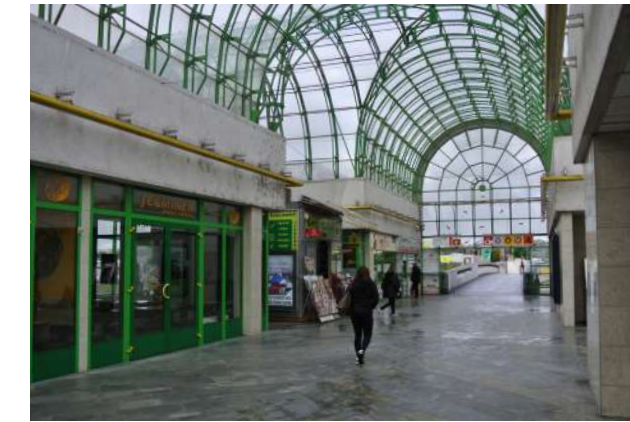
Nedostatečné stavební oddělení interiéru a exteriéru
