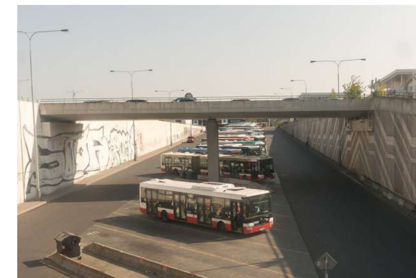
Z05 - Silniční most očekávající rekonstrukci
