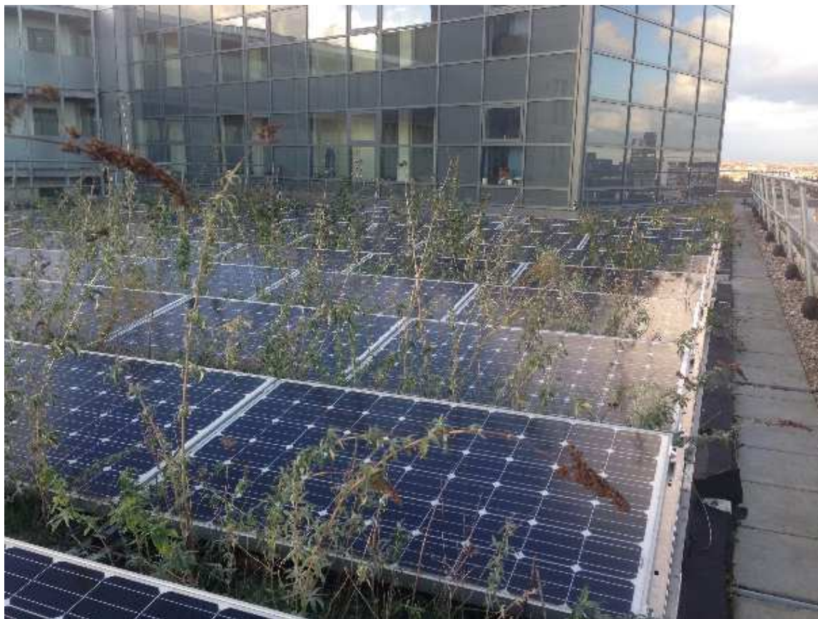
Obr. č. 7-3 Nevhodně navržená biosolární střecha
