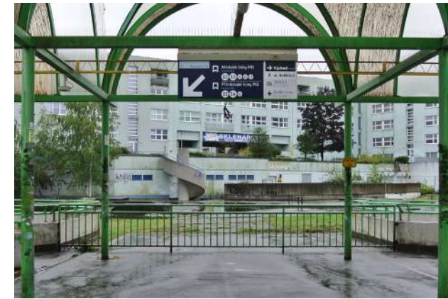
Zablokovaný výstup z lávky přímo vedoucí ze stanice metra
