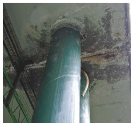
Degradace lávky vlivem zatékání do konstrukce
